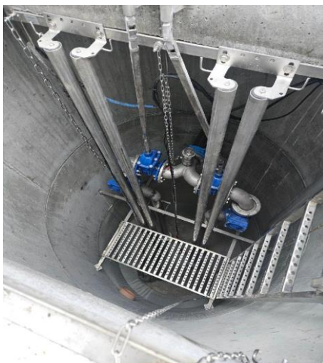
Zdj. 8.4 ZWiK – Modernizacja przepompowni ścieków „Za Regą”
