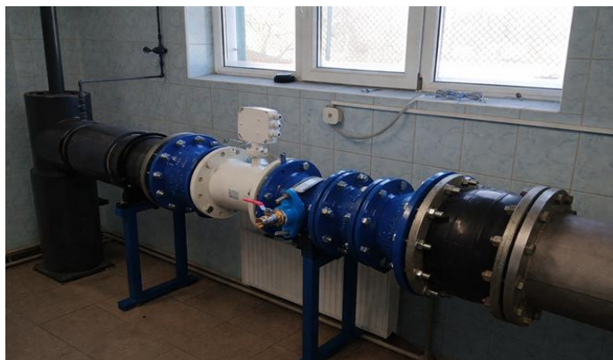
Zdj. 8.3 ZWiK – Urządzenie rejestrujące w systemie zarządzania sieciami wodociągowymi
